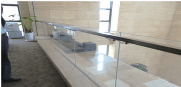
此玻璃栏杆无竖向支撑，安装不牢固不可靠
