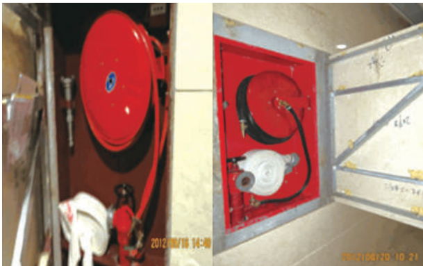
上面两张照片开启角度均不足 90° 且四周没有封口
