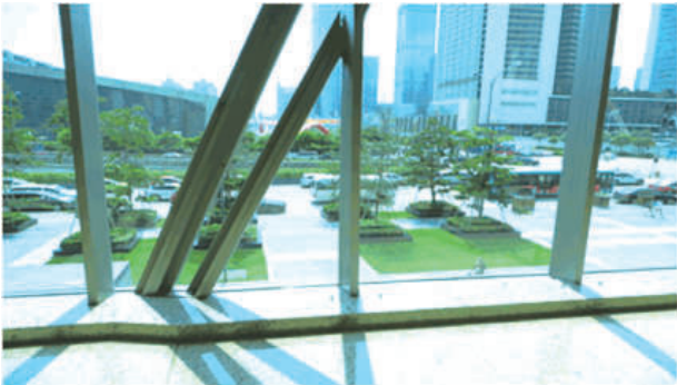
此处为玻璃幕墙，需要增设防护栏杆
